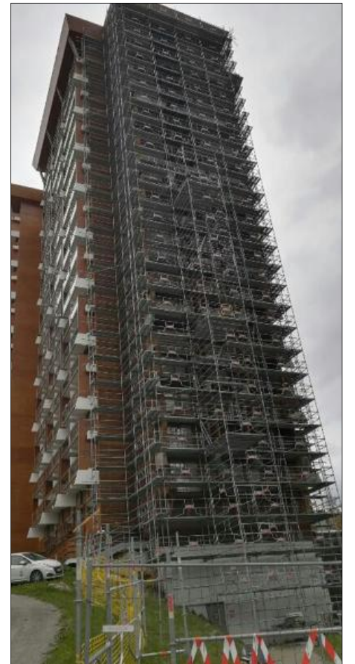
Depuis plusieurs années, la création d'une nouvelle société de location et montage d'échafaudages a connu un réel succès avec des chantiers importants, dont une des tours du Corbier.
