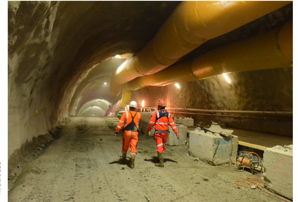
Plus de 300 personnes (une quarantaine de métiers) travaillent sur les chantiers, dans des roulements 3x8. Des exercices de sécurité sont organisés pour accroître la vigilance du personnel et sa mise hors de danger, notamment en cas d'incendie.
