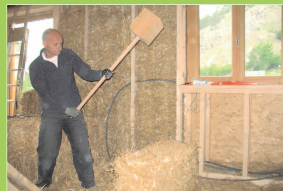
Pour assurer une parfaite isolation, la paille doit être régulièrement tassée. Un travail physique qui demande du temps et de l'énergie.
