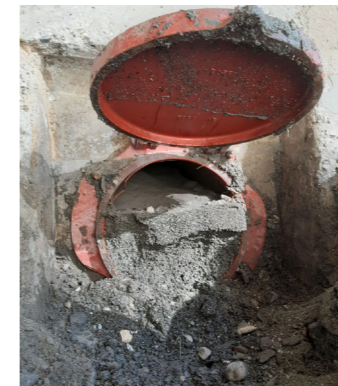
Bypass du poste de relevage obstrué
